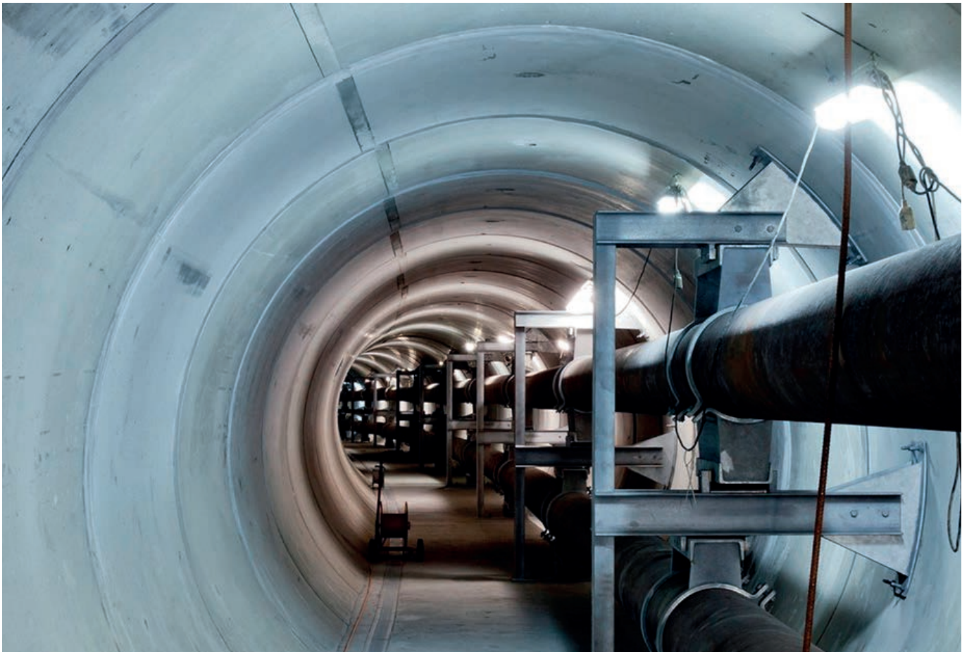
Begehbarer Fernwärme-Kanal von Energie Wasser Bern
